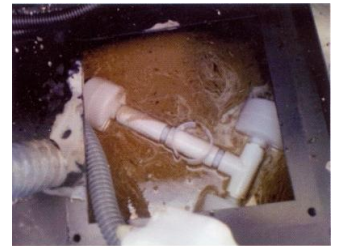
Pescante galleggiante in vasca prima della depurazione
