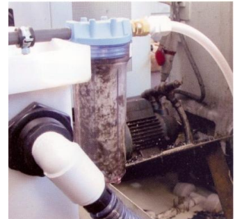
Filtro primario rimozione particelle solide, non richiede sostituzione di cartucce filtranti
